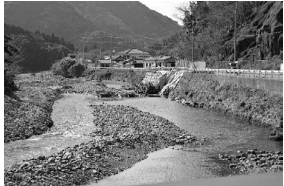
水害で陥没した道路（対馬市撮影）
